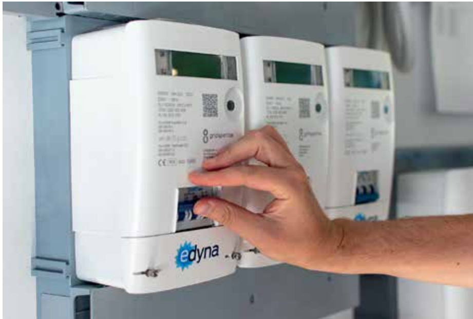
Die neuen Stromzähler „Smart Meter“
